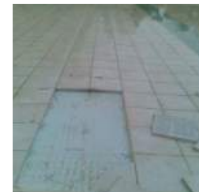
Рисунок 5.1 – Плитка, отделившаяся от основания из-за сдавливающих напряжений
