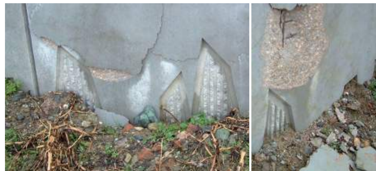
Рис. 14. Разрушение, вызванное циклами замораживания/оттаивания
