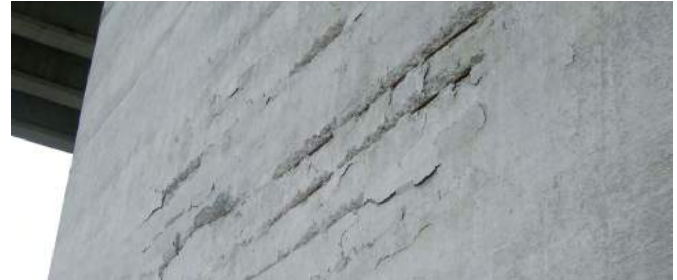
Рис. 4. Разрушение сооружения вследствие коррозии арматурных стержней
