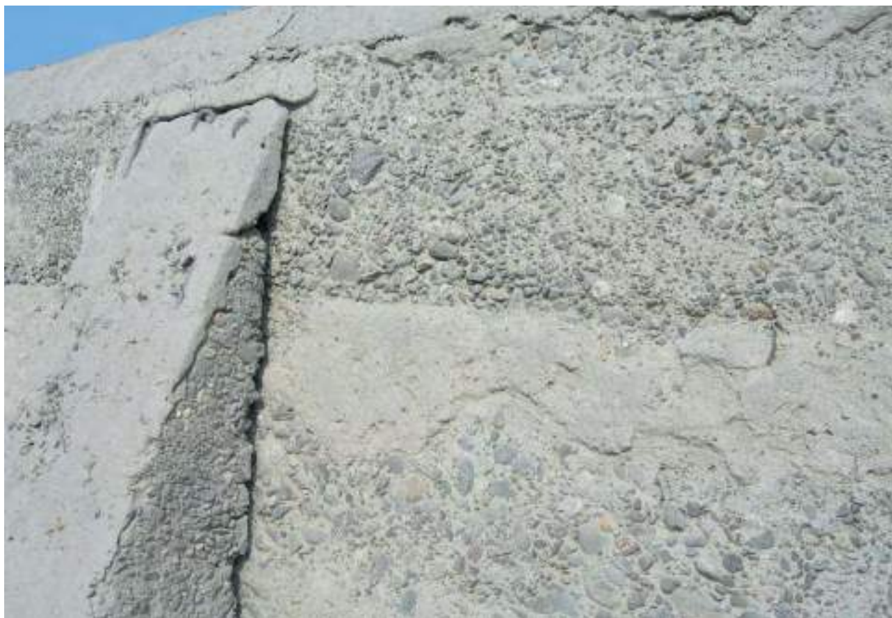
Рис. 6. Влияние выщелачивания на поверхность бетона
