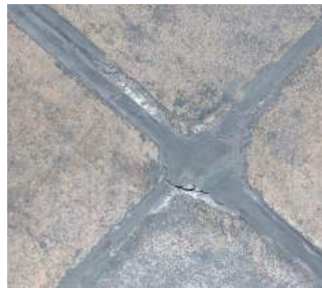
Рис. 19. Пример разрушения в стыках
