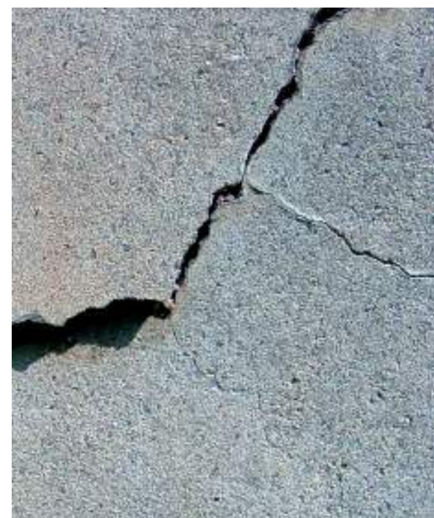
Рис. 16. Трещина в бетоне
